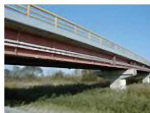
鉄橋異常振動検知システムの設置風景
