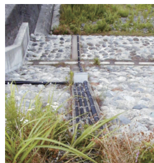
水位計設置例
